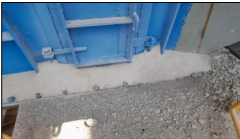
Gambar 8. Spillage Di Depan Mainhole
