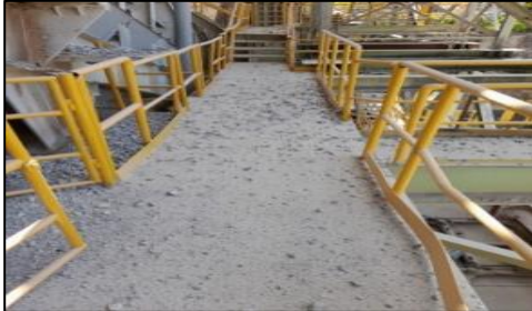
Gambar 7. Spillage Pada Lantai Kerja
