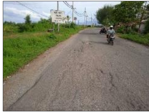
Gambar 1. Kondisi Kerusakan Jalan
